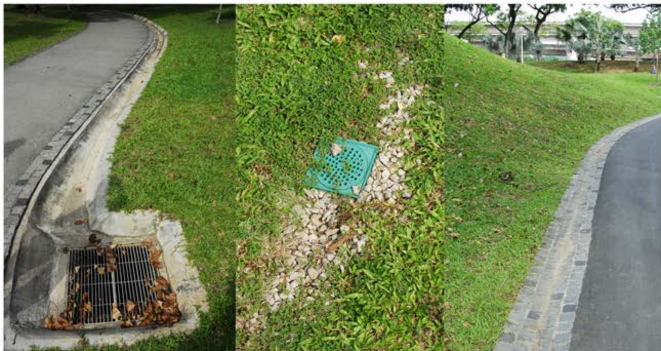
路旁汇集雨水径流的 明沟和雨水井
